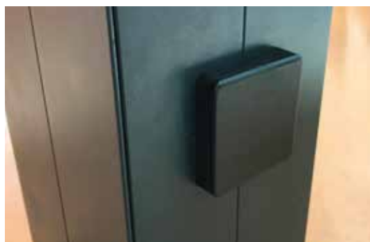
Prise 230 V encastrée dans les poteaux
